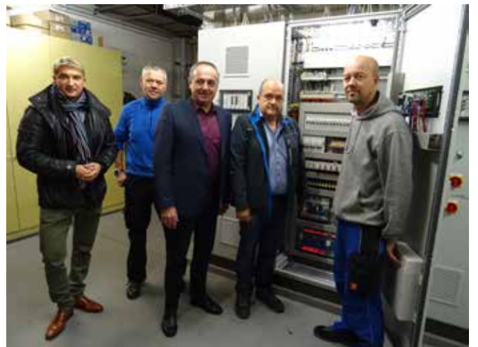
Neue Steuerung in der Kordigasthalle
