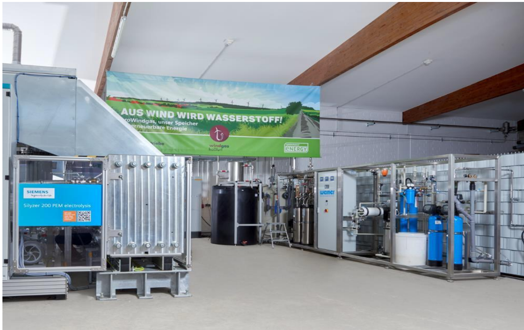
Abbildung 80: 1,25 MW el PEM-Elektrolyseur (links) mit Wasseraufbereitung (rechts) beim realen Betrieb in der Stadt Haßfurt [48]
